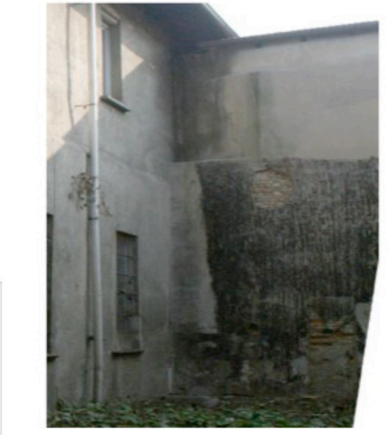
L'intonaco della parete è realizzato con malta di calce e cemento, liscio nella parte superiore, mentre nella parte inferiore è più rustico. I distacchi di intonaco lasciano intravedere la struttura muraria in mattoni
