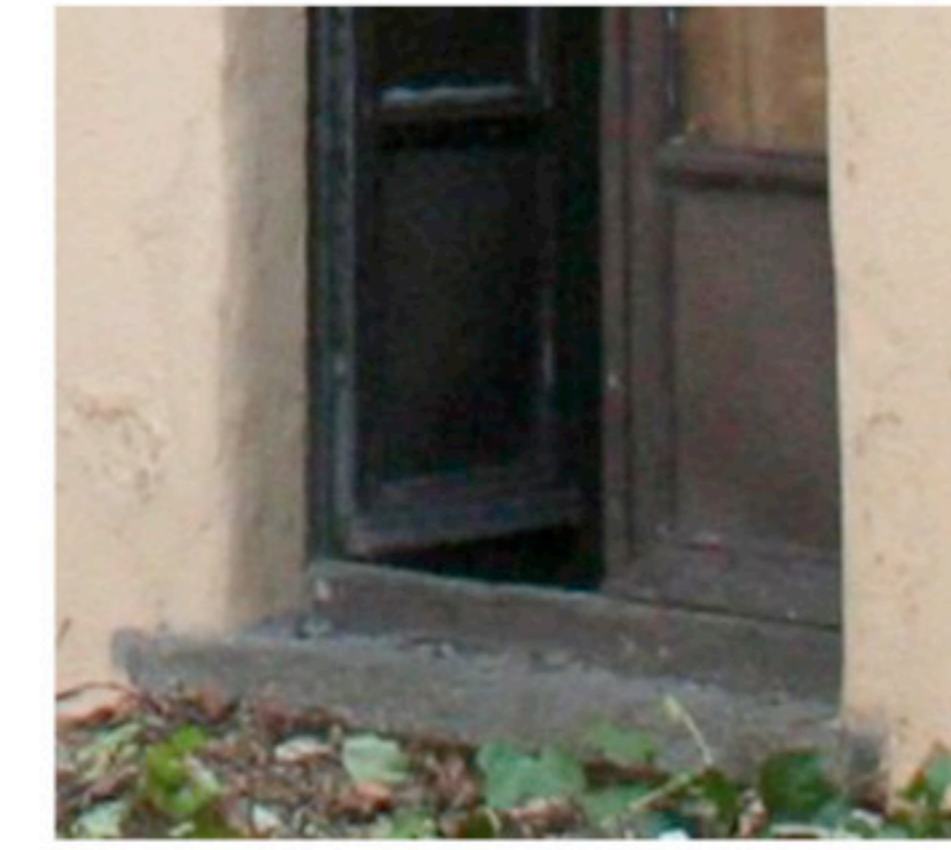
I serramenti in legno sono in uno stato accentuato sia per deposito di sporco, polvere, terriccio e depositi da un controllo puntuale si è verificato che i davanzali in pietra si notano oltre allo sporco, polvere, terriccio e depositi delle colonne è stata in passato cerchiata e ricostruita con del cemento. Questo cemento ha
