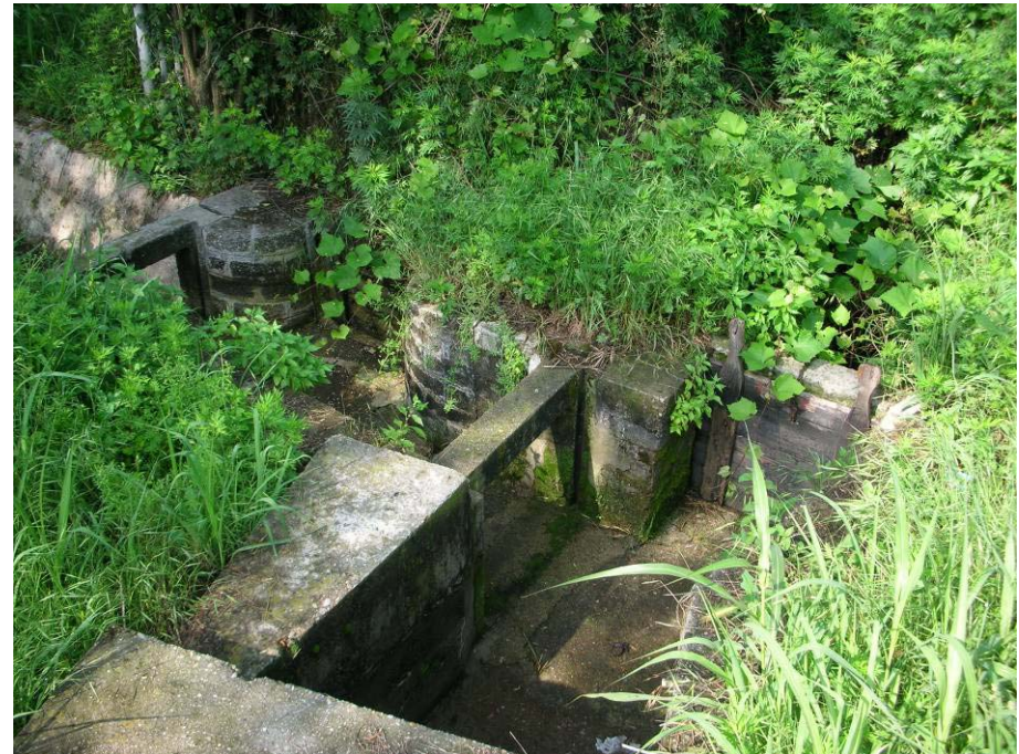
Foto 49: partitore su canale secondario Villoresi
