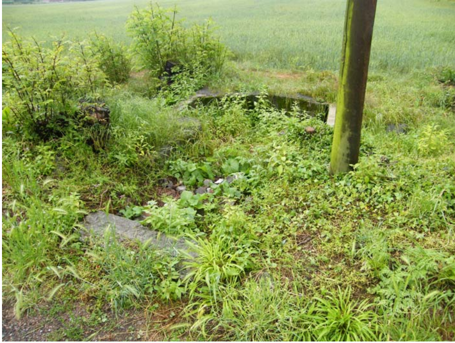
Foto 1, 2: Canale 1/AVLP - manufatti di derivazione abbandonati lungo adacquatrice dismessa
