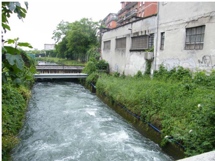
Foto 17: presa abbandonata lungo il Canale Villoresi
