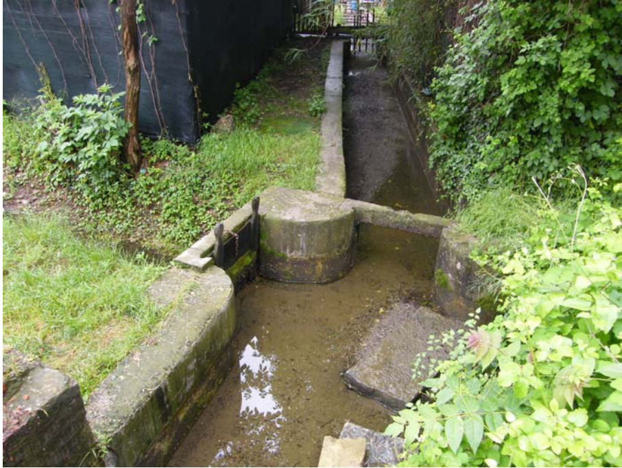
Foto 11: particolare di un partitore sul canale 1/CVLP
