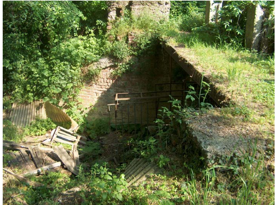
Foto 73: Manufatti di presa abbandonati in corrispondenza dell'incrocio tra Roggia San Vittore e Roggia Rizzarda
