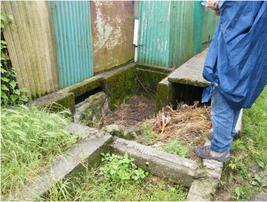
Foto 19: manufatto partitore sul 10VLL in stato di abbandono
