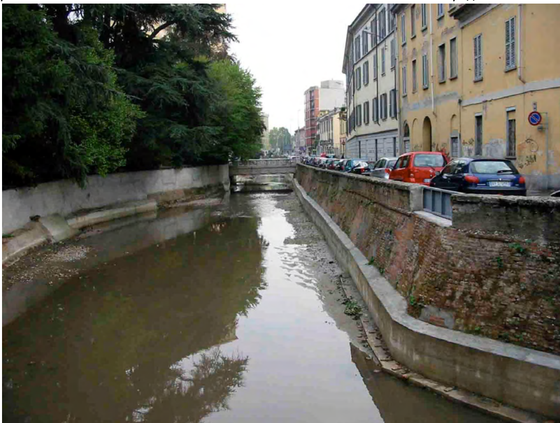
Figura A5.3 – Rinforzi al piede dei muri di sostegno delle sponde del Lambretto (si vede la paratia mobile sul parapetto) Foto 20
