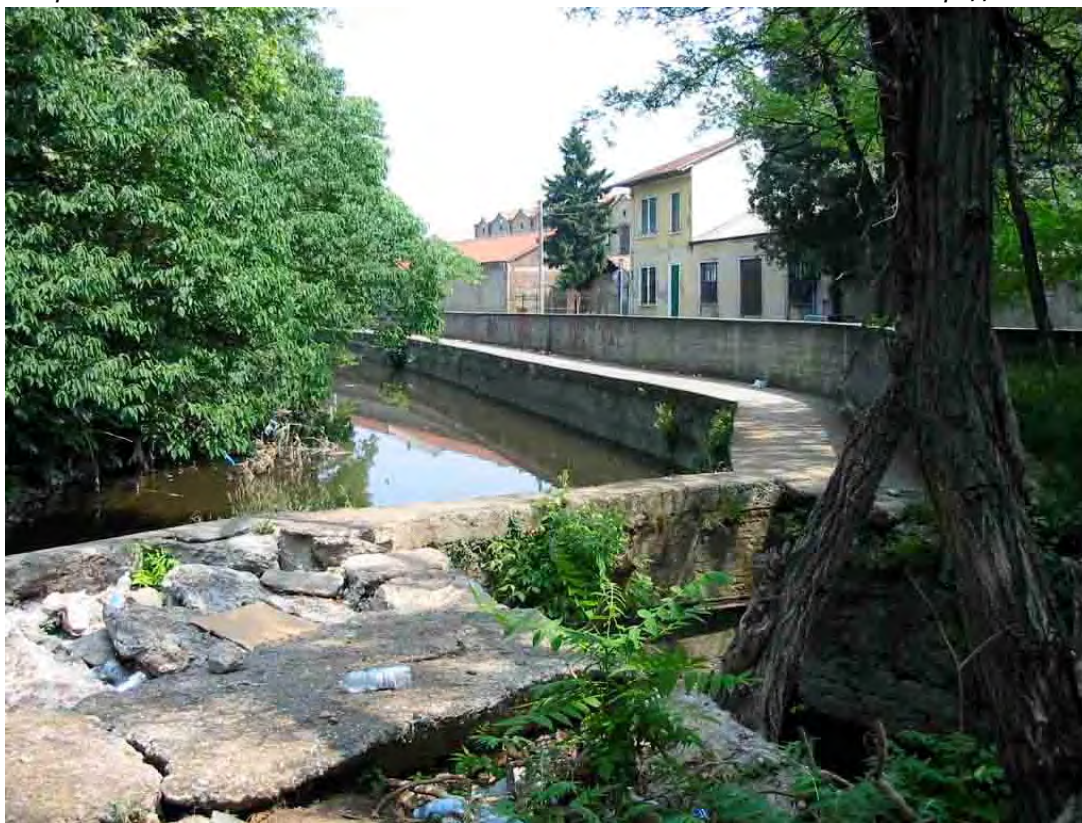
Figura A5.1 – Chiuse di derivazione della Roggia Lupa dal Lambro presso S.Gregorio
