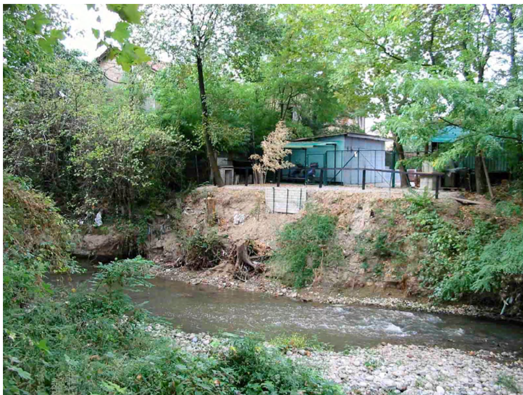
Figura A5.2 - Occupazione di parte del corso del fiume mediante riporto in terra. Lambro poco a monte della confluenza con la roggia Lupa (Foto 31)
