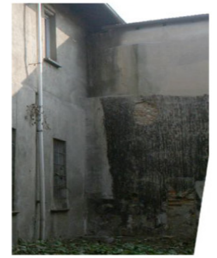
L'intonaco della parete è realizzato con malta di calce e cemento, liscio nella parte superiore, mentre nella parte inferiore è più rustico. I distacchi di intonaco lasciano intravedere la struttura muraria in mattoni.
