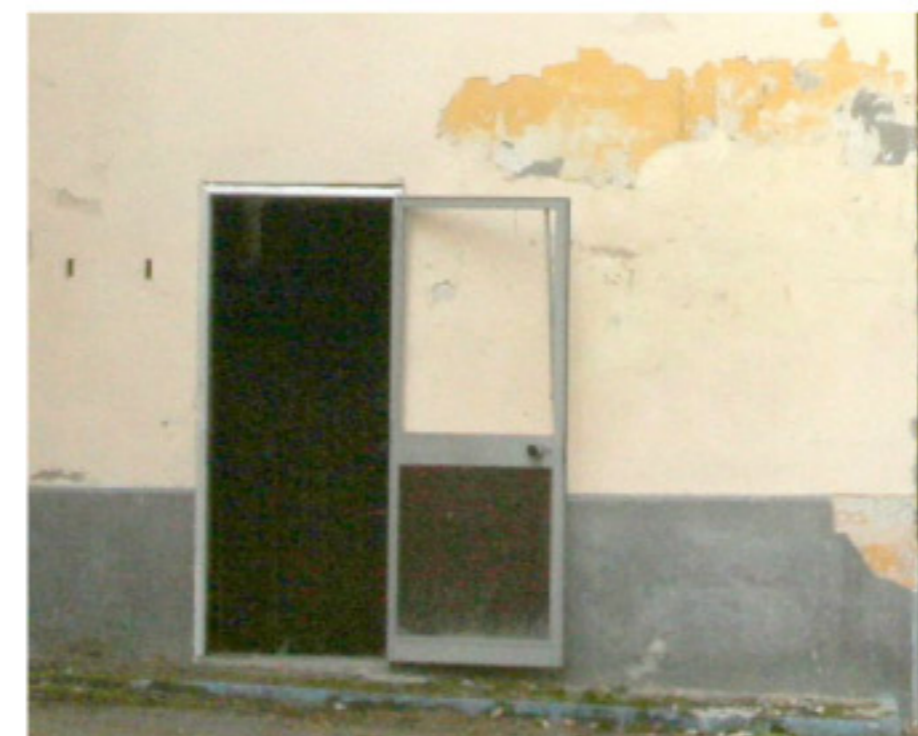
Particolare della zoccolatura realizzata con malta di cemento, ricoperta con intonachino plastico tipo "terranova"
